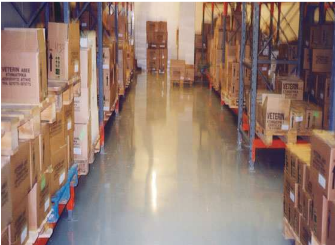
Тънкослойно епоксидно покритие Durofloor R, положено в склад на ветеринарна фармацевтична компания.
